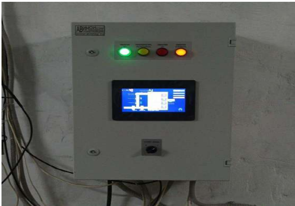
Рисунок 2. Шкаф с компьютером управления климатической установки.
